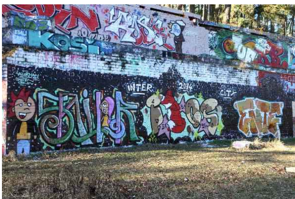
Graffiti an Bahnbrücke
